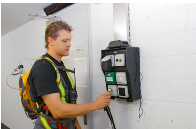
3 Selon la situation, les systèmes d'alimentation en oxygène à la demande peuvent accroître le bien-être des collaborateurs.
