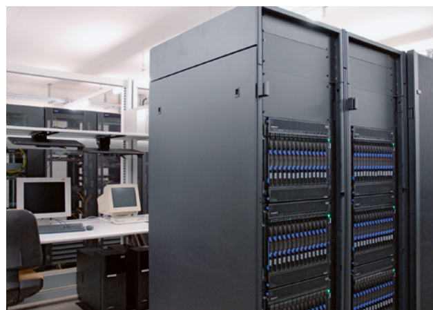
2 Dans les locaux de serveurs, une atmosphère appauvrie en oxygène offre une protection accrue contre les incendies.
