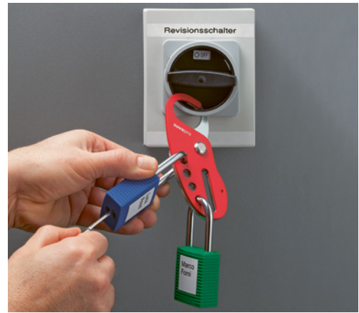
1 Gesicherter Revisionsschalter mit Vorhängeschloss und Mehrfach-Schliessbügel
