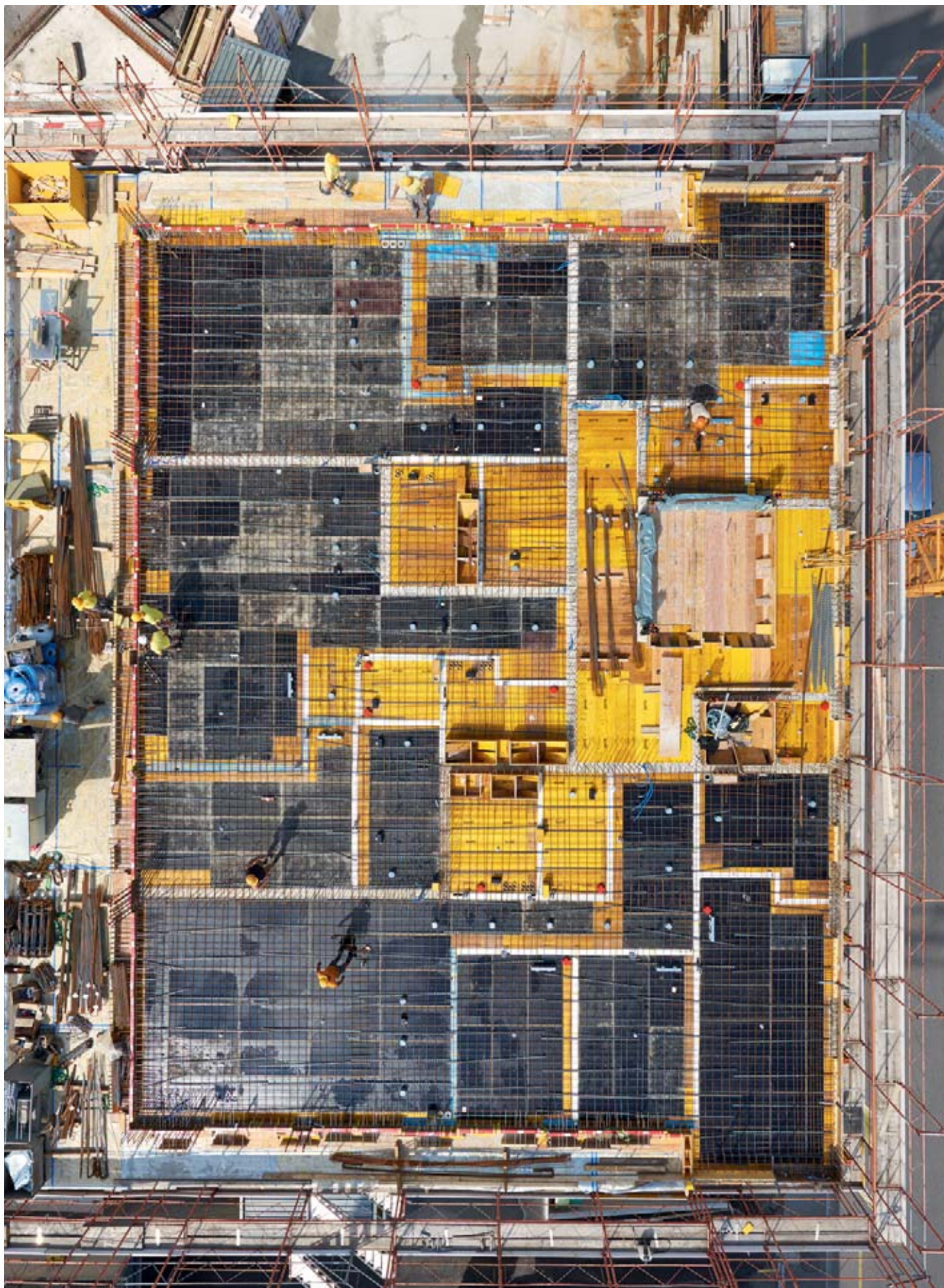
Sur ses chantiers, Butti Bauunternehmung AG attache autant d'importance à la sécurité qu'à ses objectifs économiques.
