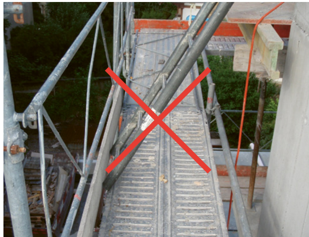
4 So nicht! Diese Leiter wird an einer instabilen Unterlage angelegt. Versagt das Bordbrett, ist der Absturz programmiert.
