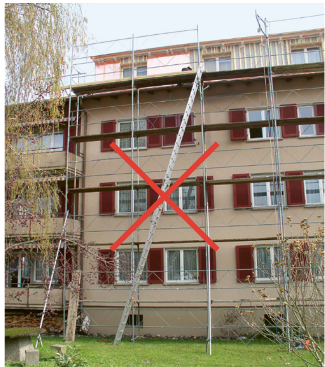
1 Tragbare Leitern sind als Zugang zu Gerüsten verboten.
