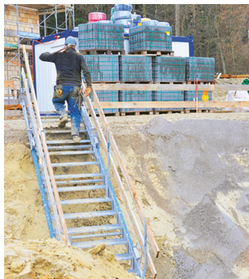
1 Sécuriser les accès au fond de la fouille.
