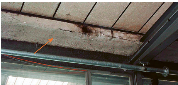
Crépi acoustique amianté
