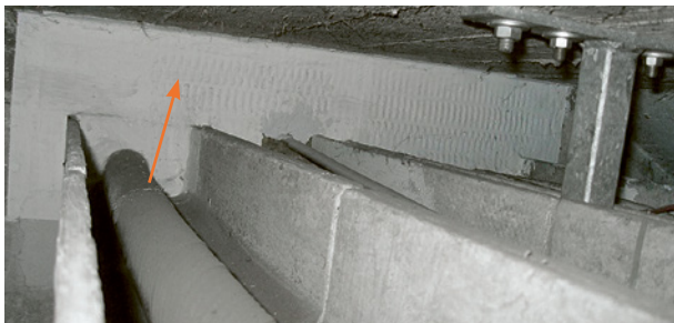
Traversée de câbles avec cloison pare-feu
