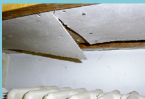
Panneaux légers amiantés
