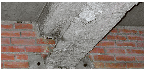
Amiante floqué sur poutre métallique
