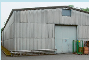
Plaques ondulées amiantées
