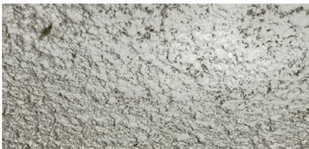
Crépi acoustique amianté
