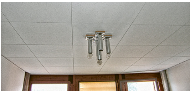
Plaques de faux plafonds
