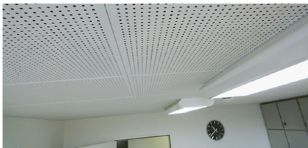
Plaques de faux plafonds
