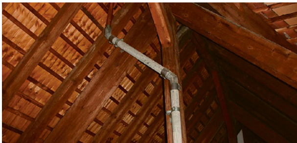
Tuyau d'évacuation d'air
