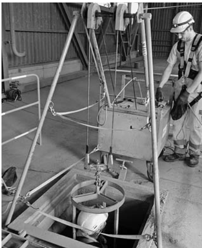
11 Siloeinstieg mittels Siloeinfahrgerät mit Arbeitskorb. Diese Einheit muss als Ganzes CE-konform sein.
