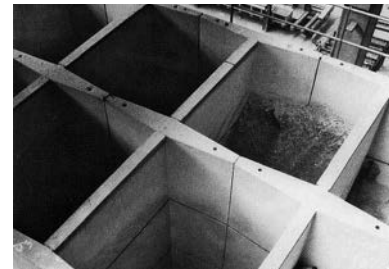
4 Beste Zutrittsbeschränkung: Silos ohne fest installierte Leitern.
