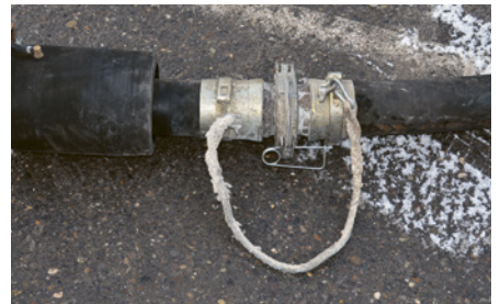
8 Dispositivo di sicurezza del tubo flessibile terminale come indicato dal fabbricante
