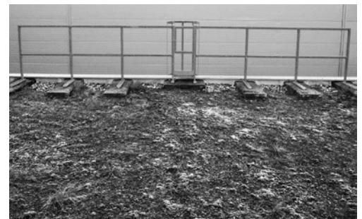
6 Point de sortie protégé des deux côtés par des garde-corps le long du bord de chute.
