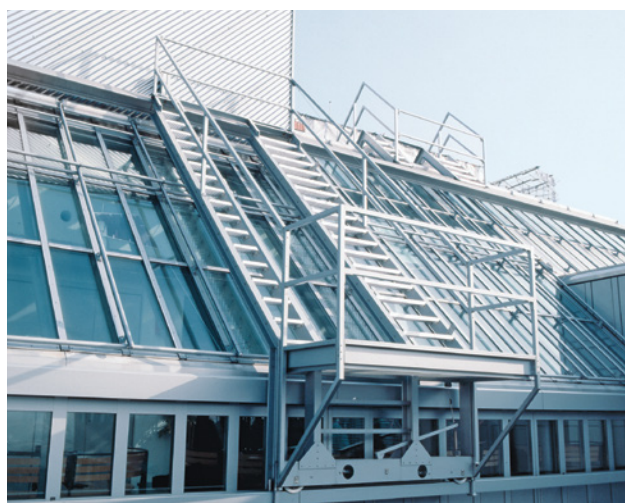
10 Passerella mobile per la pulizia della parete esterna dei tetti di vetro inclinati. Grazie all'apertura centrale e alle scale poste ai lati è possibile eseguire la sostituzione delle vetrate rotte direttamente dalla passerella.
