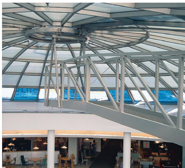
14 Passerella mobile in un edificio rotondo. Da questa installazione è possibile pulire le vetrate interne del soffitto ed eseguire interventi di manutenzione generale.
