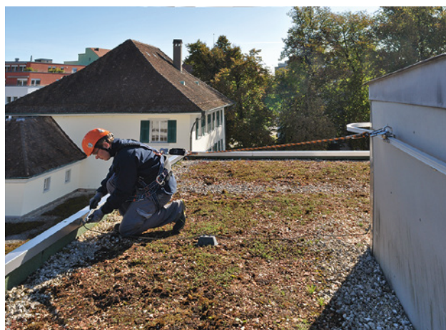
27 I sistemi di trattenuta sono dispositivi di protezione individuale che evitano a chi lavora sui tetti di raggiungerne il bordo e quindi di cadere. Occorre sempre preferire tali sistemi a quelli di arresto caduta.
