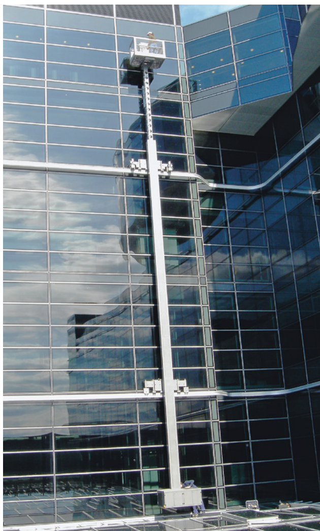
13 Impianto di sollevamento a colonna per la pulizia delle vetrate esterne, dotato di cesta portapersona su un montante telescopico.
