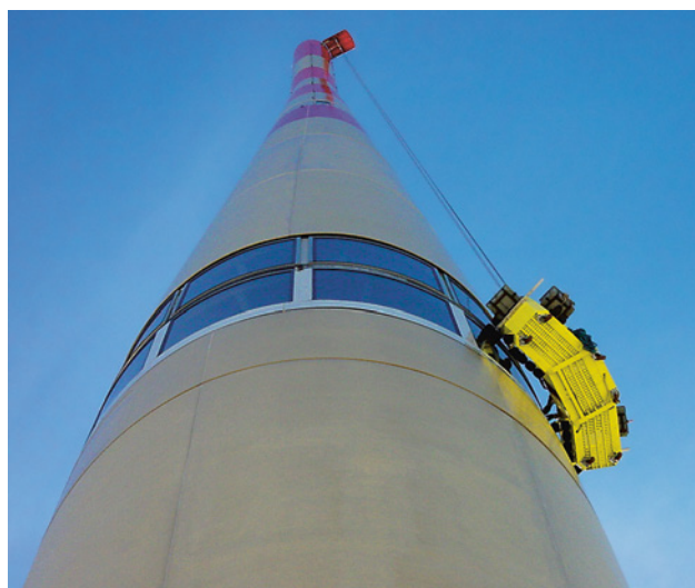
12 Torre di trasmissione provvista di un'installazione speciale adattata alla curvatura.
