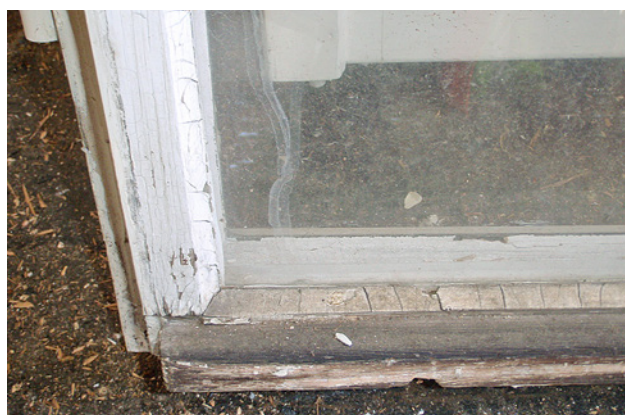
1 Mastic à l'huile de lin amianté d'une fenêtre en bois
