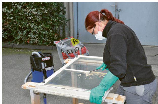
2 Retrait du mastic de fenêtres amianté au ciseau à bois ou à la spatule
