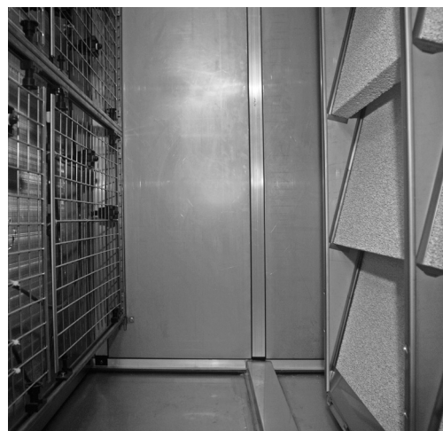
Interno di un umidificatore ibrido. Lo stato d'igiene deve essere controllato periodicamente.
