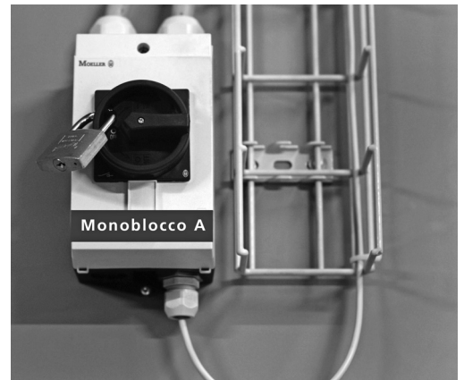
Blocco dell'impianto con un lucchetto specifico.
