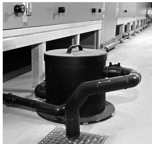
Sifone centrale per acqua di condensa.
