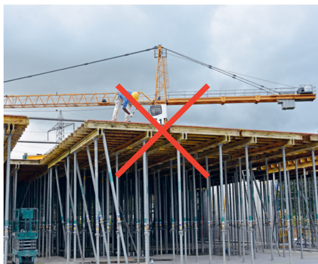
2 Interdit: coffrage de dalle dépourvu de protection contre les chutes en cas de hauteur de chute supérieure à 2 m
