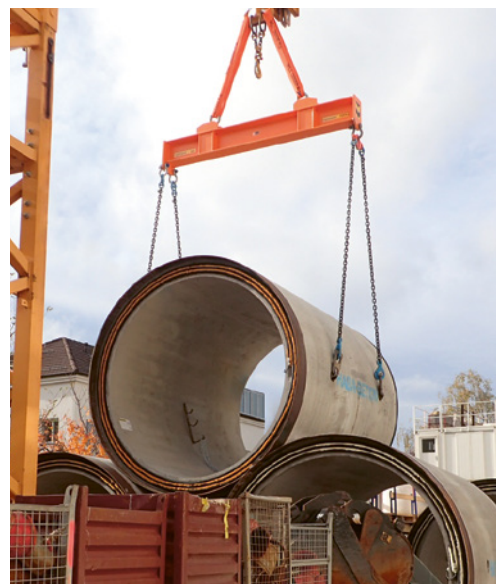
4 Per il trasporto del materiale (qui in verticale) è indispensabile avvalersi di attrezzature e installazioni adeguate.
