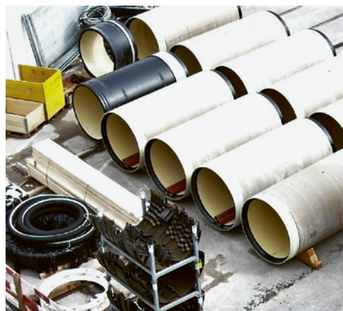
2 Deposito a norma per lo stoccaggio temporaneo dei tubi di spinta.
