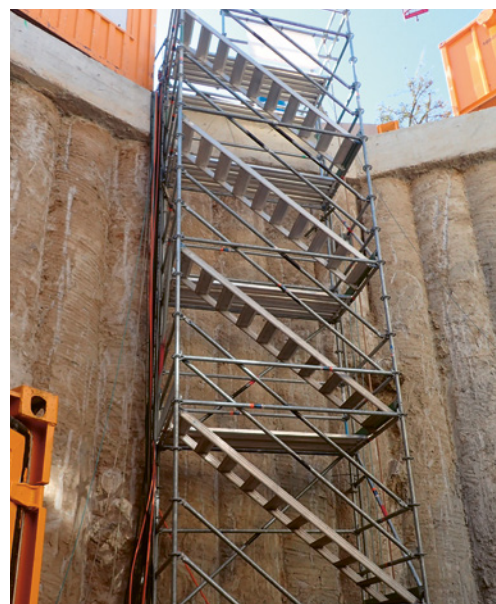
6 Un posto di lavoro con accessi sicuri permette anche di intervenire rapidamente in situazioni di emergenza.
