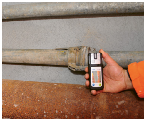
3 Per lavorare in condizioni di sicurezza è fondamentale che la qualità dell'aria nella zona di avanzamento sia monitorata.
