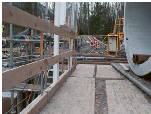
1 È molto importante che i pozzi di partenza e di arrivo abbiano misure di protezione anticaduta e accessi sicuri.
