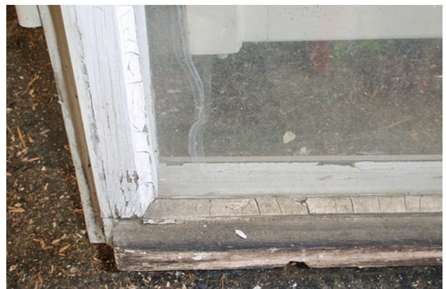
1 Asbesthaltiger Leinölkitt an einem Holzfenster
