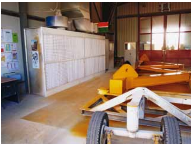
17 Absaugwand, die es ermöglicht, gelegentlich Spritzlackierarbeiten in einer grossen Halle gefahrlos auszuführen.
