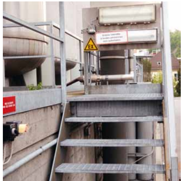
23 Zündquellen sind innerhalb von Zonen mit Explosionsrisiken verboten. Die Zonen sind durch «EX»-Schilder zu kennzeichnen.
