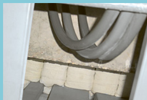
Brandabschottung mit Asbestkissen
