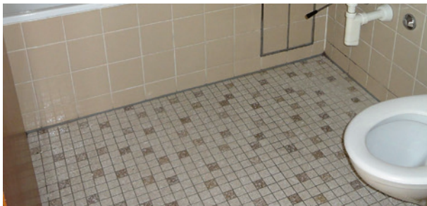
Platten an Boden und Wänden mit asbesthaltigem Kleber
