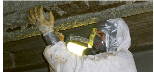
Entfernen nur durch anerkanntes Asbestsanierungsunternehmen
