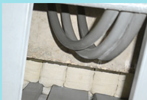
Brandabschottung mit Asbestkissen
