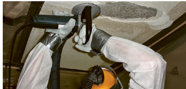
Entfernen nur durch anerkanntes Asbestsanierungsunternehmen
