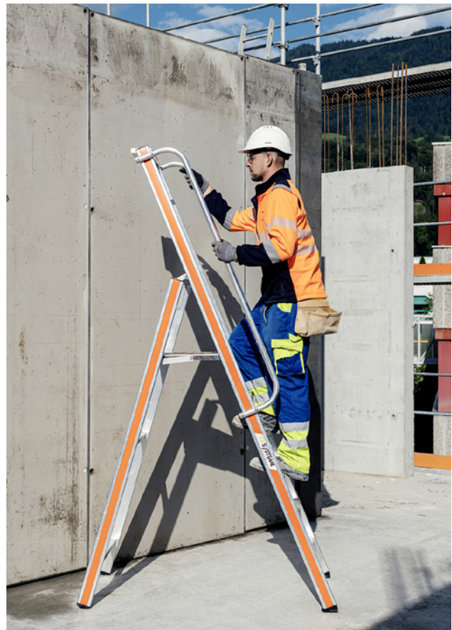
27 Leichte Plattformleiter sicher besteigen
