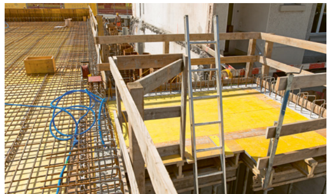
32 Die Leiter ragt mindestens 1 m über die Kante hinaus: Ein sicherer Überstieg ist gewährleistet.
