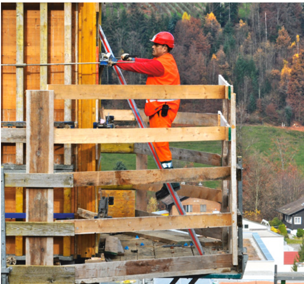
4 Zusätzliche Schutzmassnahme (hoher Seitenschutz) bei erhöhter Absturzstelle
