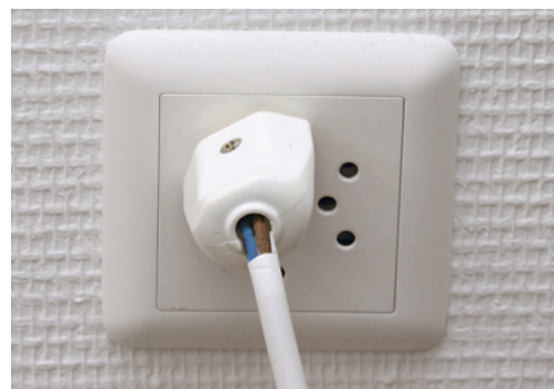
Fig. 22: Sostituire prontamente i cavi elettrici difettosi.
