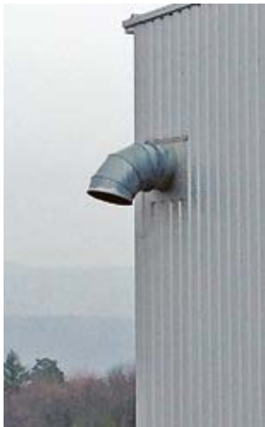
4 Dépoussiéreur avec évacuation de l'air vers l'extérieur
