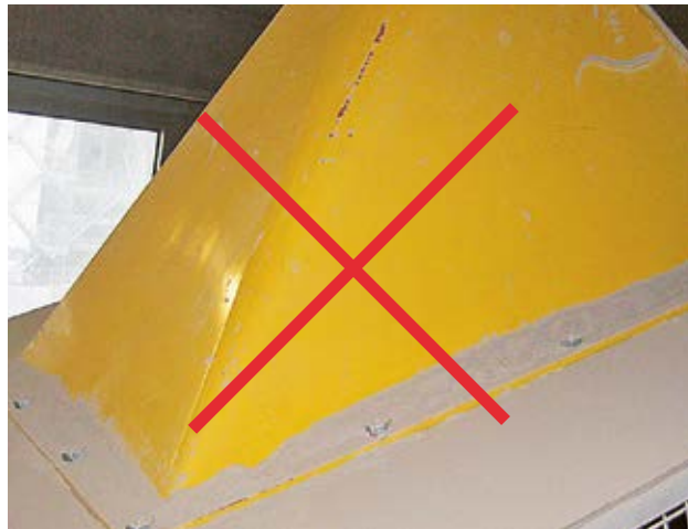
5 Dépôts de poussières: entretien insuffisant
