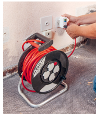
Regel 8 Nur Steckdosen mit FI-Schutz benutzen
