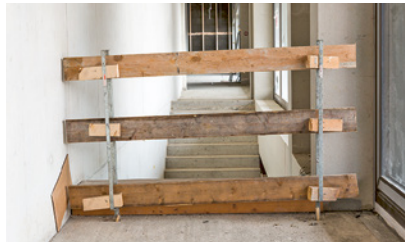
2 Mit Seitenschutz gesicherte Absturzkante
