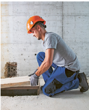
Regel 5 Bodenöffnungen und Dachöffnungen sichern
