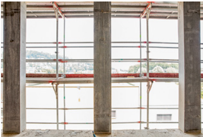
1 Das Fassadengerüst schützt vor einem Absturz durch das offene Fenster.
