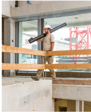
Regel 2 Absturzkanten sichern – ab einer Absturzhöhe von 2 m
