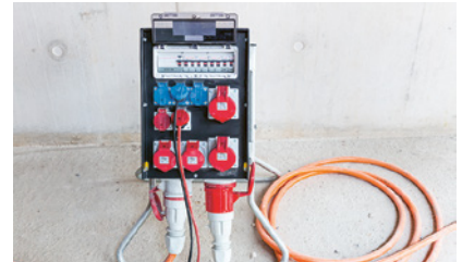
3 Baustromverteiler mit FI-Schutz
