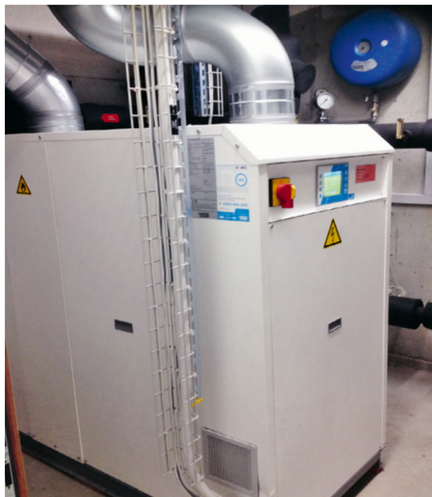
Système frigorifique dans une enceinte ventilée.
