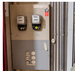
1 EA contenant de l'amiante
