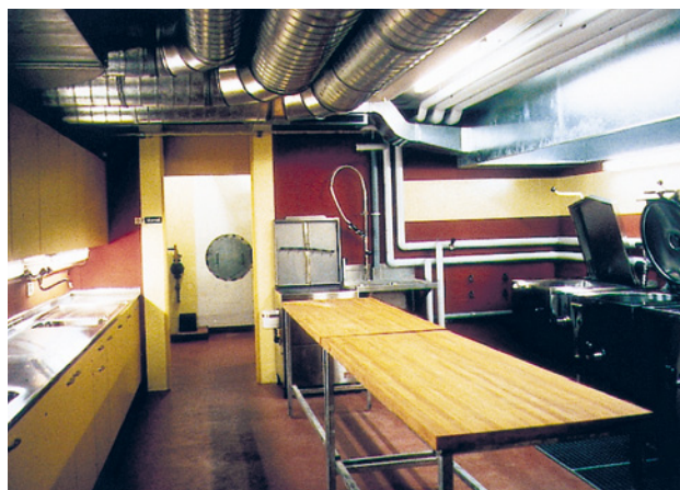
Fig. 26 Eclairage d'un local au moyen de tubes fluorescents
