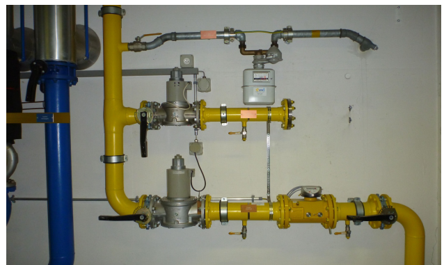
1 Installation de conduites de gaz naturel apparentes
