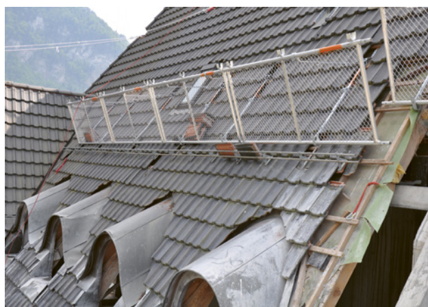
1 Parete di ritenuta installata correttamente
