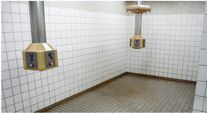
Carrelage au sol et aux murs fixé avec de la colle amiantée
