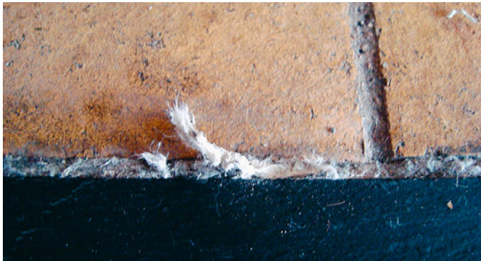
Cordon en amiante dans une cheminée
