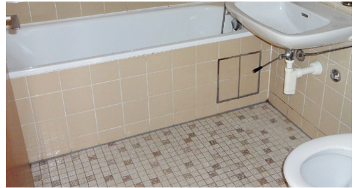
Carrelage avec colle amiantée
