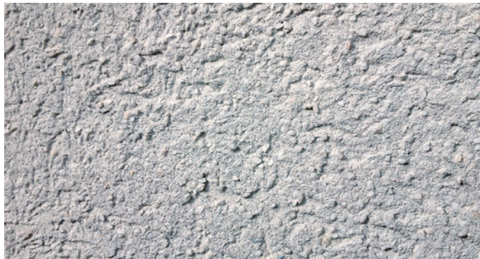
Crépi acoustique amianté
