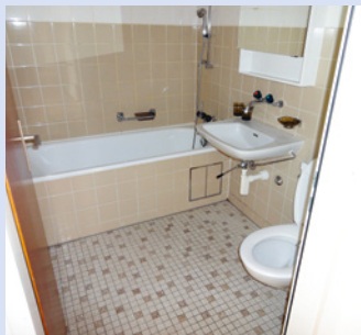
Colle amiantée derrière le carrelage
