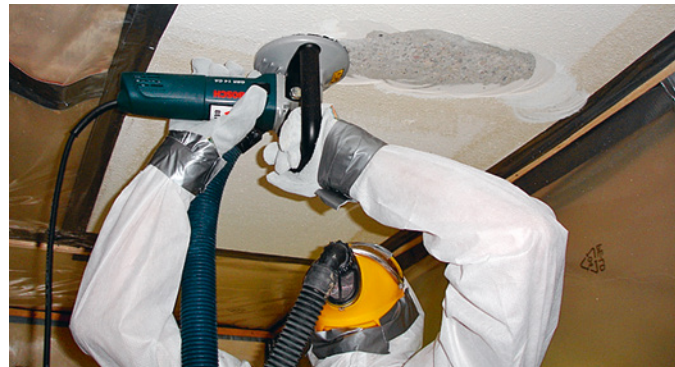
Enlèvement uniquement par des entreprises en désamiantage reconnues
