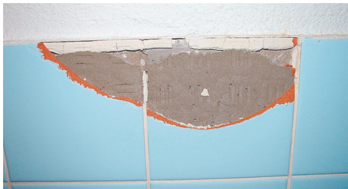
<1% Amiante chrysotile dans la colle
