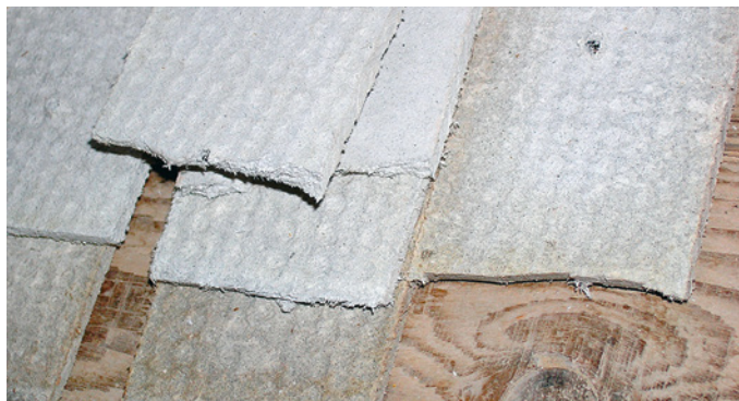
Panneaux légers amiantés
