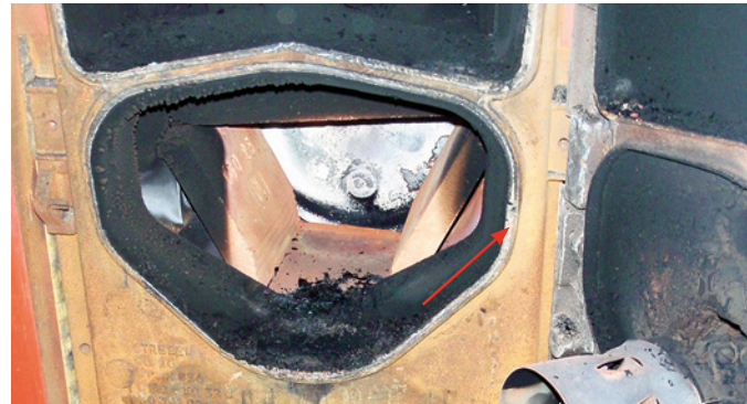
Cordon en amiante servant de joint
