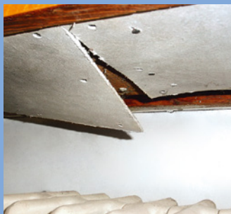
Panneaux légers amiantés
