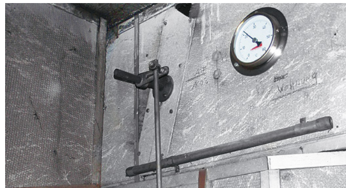
Canal d'aération avec plaques en fibrociment
