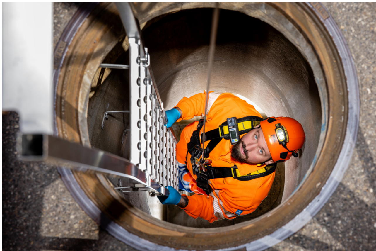
4 Le scale fisse a pioli sono installate in modo stabile alla costruzione e non possono scivolare. In questo modo si riduce notevolmente il rischio di caduta quando si entra o esce dal pozzo.
