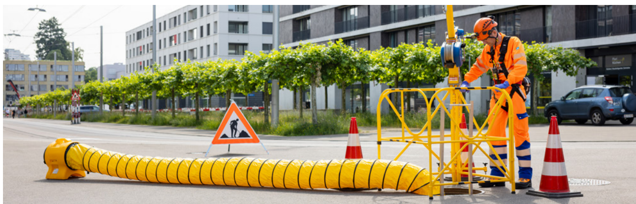
7 Grazie a una ventilazione artificiale, l'aria viziata viene scaricata all'esterno in condizioni di sicurezza.
