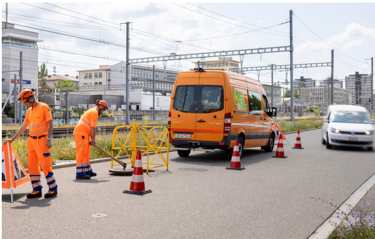
14 Mettere in sicurezza la zona di lavoro contro i pericoli derivanti dalla circolazione.
