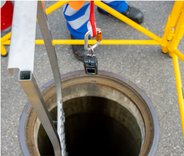
9 Se non vi è alcuna ventilazione artificiale, occorre svolgere una misurazione di declassamento.
