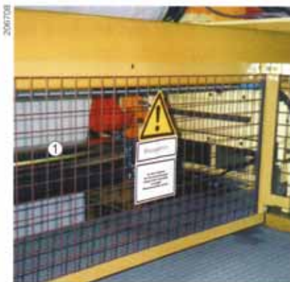
Figure 23: Poste de déroulage d'une installation d'application de revêtements (entreprise de traitement des matières plastiques). La zone d'entraînement et d'écrasement (1) des cylindres dérouleurs est recouverte.
