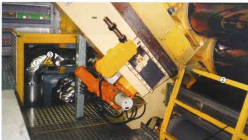
Figure 42: Calandre dans une entreprise de transformation des matières plastiques. Les tuyaux de chauffage (1) des cylindres de calandre sont isolés. L'installation est pourvue d'un garde-corps (2) prévenant toute chute sur les cylindres chauffés. En outre, le panneau «Attention, pièces chaudes» (3) met en garde contre le danger que présentent les surfaces chaudes.
