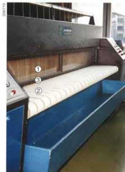
Figure 37: Lisseuse à auges multiples de blanchisserie.
