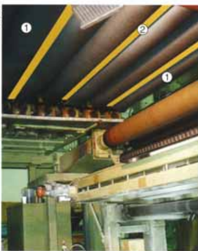
Figure 20: Calandre dans une entreprise de transformation des matières plastiques. Les barres de protection (2) s'imposent car les mains peuvent atteindre les zones d'introduction sur les cylindres refroidisseurs (1).
