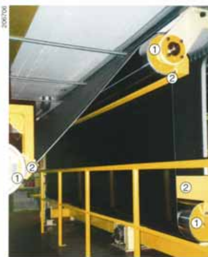
Figure 21: Installation d'application de revêtements (entreprise de traitement des mat. plastiques). Les zones d'engagement de la bande sur les cylindres de déviation (1) sont protégées par des barres de protection (2).
