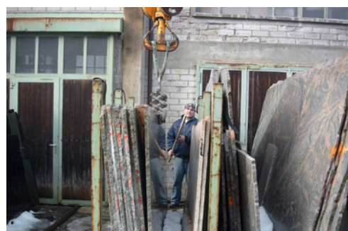
3 Prelievo, imbracatura e trasporto in sicurezza di una lastra. L'addetto si trova al di fuori della zona di pericolo.
