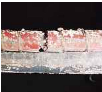
Figura 6: difetto in un impianto di saldatura riscontrato durante un'ispezione
