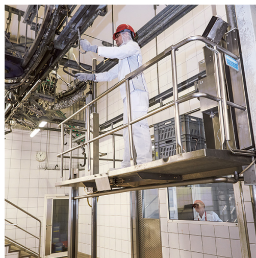
Figura 6: protezione anticaduta adeguata
