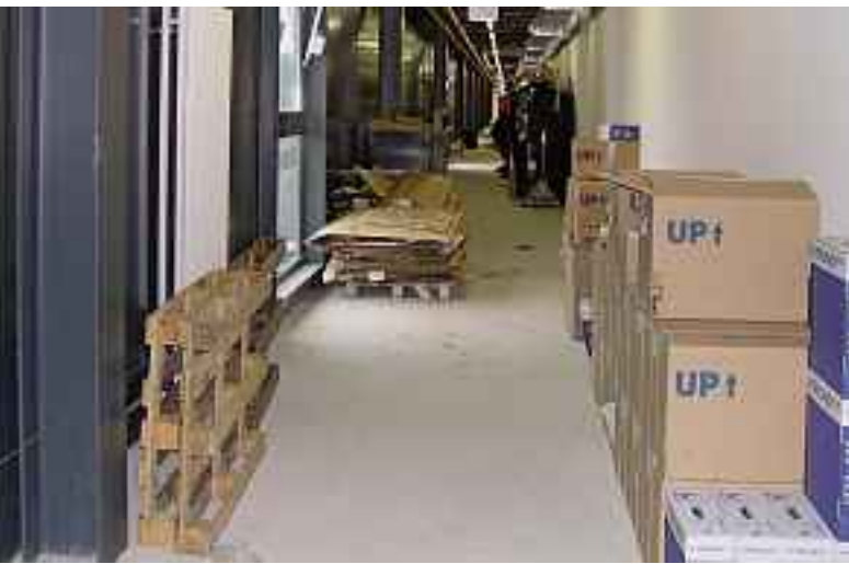
Un problème dans de nombreuses entreprises: des voies de circulation et de fuite servant de lieux de stockage et encombrées peuvent être à l'origine de chutes graves et même de cas mortels en cas d'incendie.
