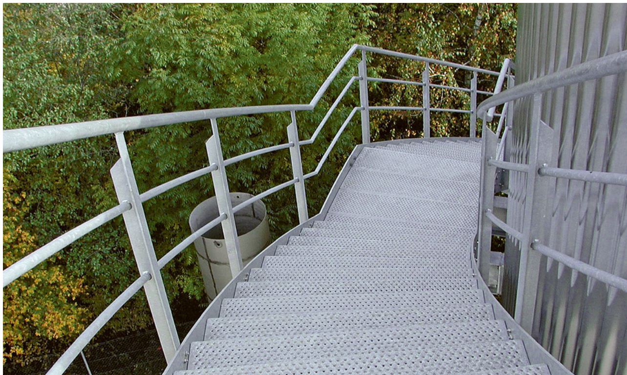
16 Parapetti sui lati di una scala con bordi di arresto al piede. La distanza libera fra il corrimano e il corrente intermedio superiore, i due correnti intermedi, il corrente intermedio inferiore e il fianco della scala non supera i 500 mm. Il numero di correnti intermedi dipende dalla funzione del parapetto.
