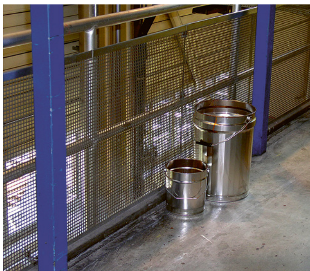
17 La griglia a maglie strette fissata sul parapetto fornisce un'efficace protezione contro la caduta di oggetti o persone.
