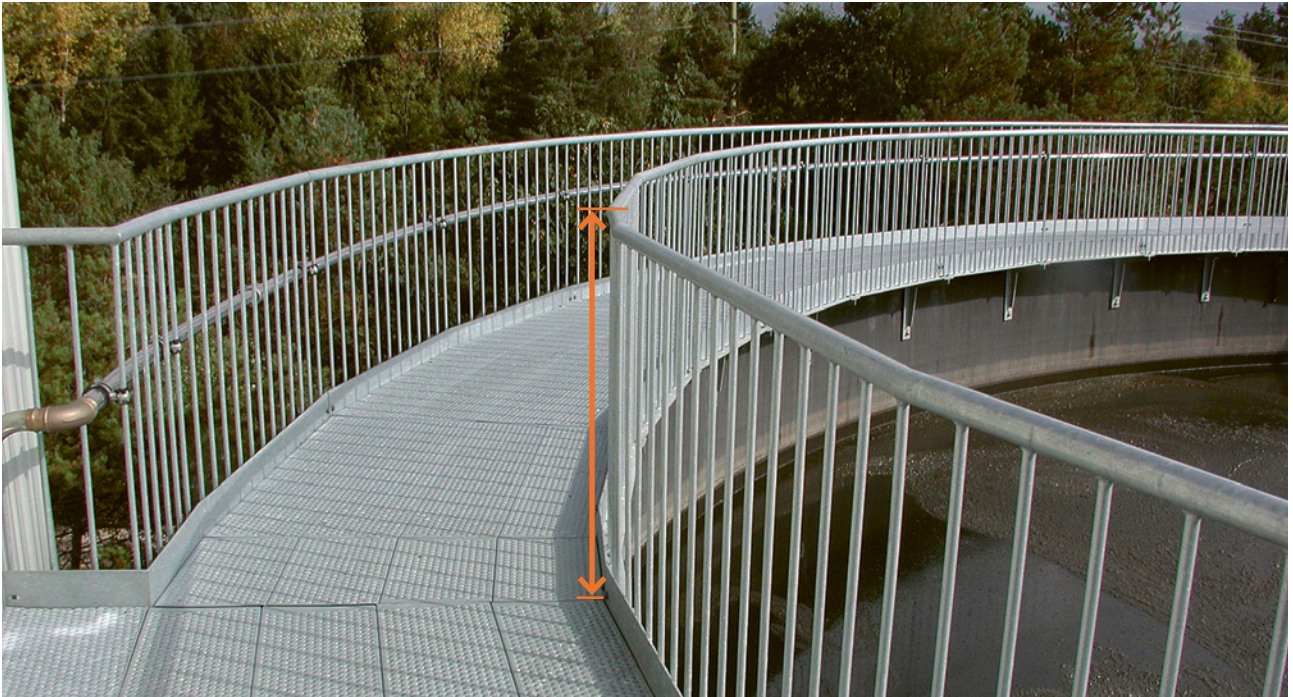
10 L'altezza del parapetto è di 1,10m calcolata dalla superficie di calpestio allo spigolo superiore del corrimano.
