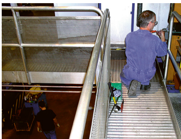
20 Parapetto su una piattaforma di lavoro con bordi di arresto al piede e griglia di riempimento a maglie strette lungo il lato rivolto verso il vuoto. Questa struttura impedisce che una persona accovacciata oppure degli oggetti possano precipitare sulla via di circolazione sottostante.
