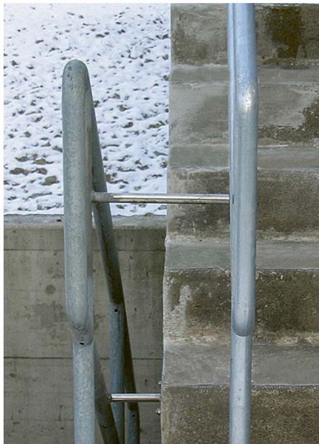
15 Parapetto con sufficiente spazio libero fra il corrimano e la scala. Le estremità del corrimano sono realizzate in modo che non ci si possa tagliare con spigoli vivi o rimanere impigliati con i vestiti.
