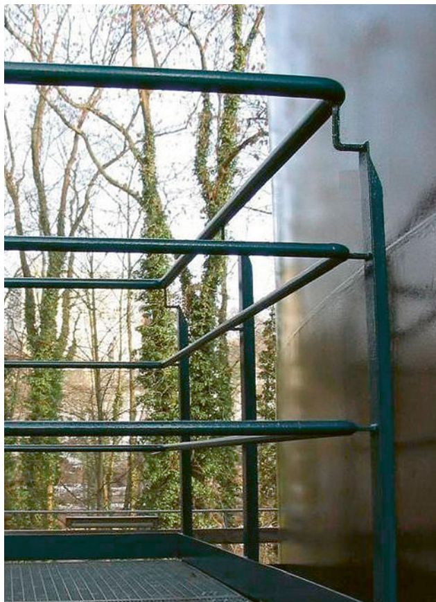
14 Parapetto su un pianerottolo con corrimano staccato dalla parete. Lo spazio libero tra il corrimano e la parete è come minimo di 75mm.
