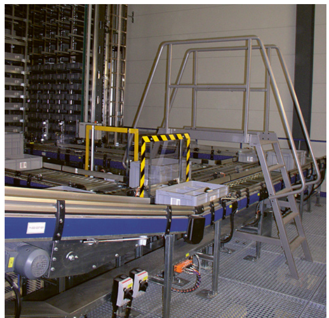
6 I parapetti su entrambi i lati della passerella proteggono efficacemente persone e oggetti dalla caduta all'interno del trasportatore automatico. Anche le scale a castello sono dotate di corrimano su entrambi i lati.
