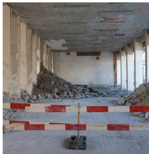
3 È necessario sbarrare la zona di pericolo per impedire l'accesso.
