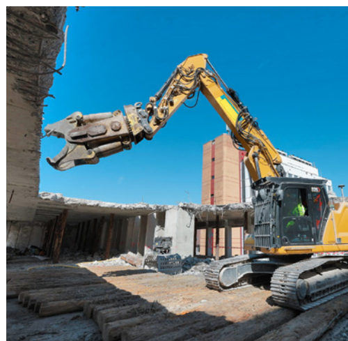
2 Durante la demolizione meccanica, nella zona di pericolo non possono sostare persone.
