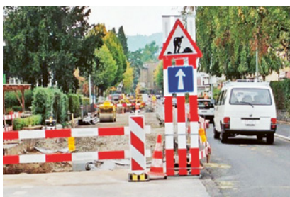
1 Le chantier doit être signalé en permanence.
