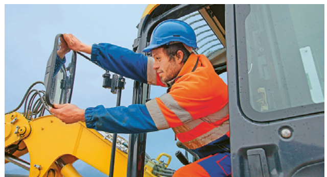
2 Régler et entretenir correctement les accessoires des engins de chantier.
