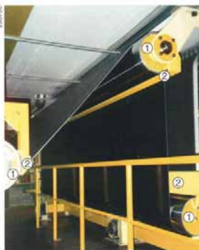
Bild 21: Beschichtungsanlage in einem Kunststoff verarbeitenden Betrieb. Die Bandauflaufstellen an den Umlenkwalzen (1) sind mit Schutzstangen (2) gesichert.
