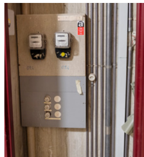
1 Apparecchiatura assiemata di comando contenente amianto
