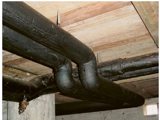
2 Guaina bituminosa contenente amianto
