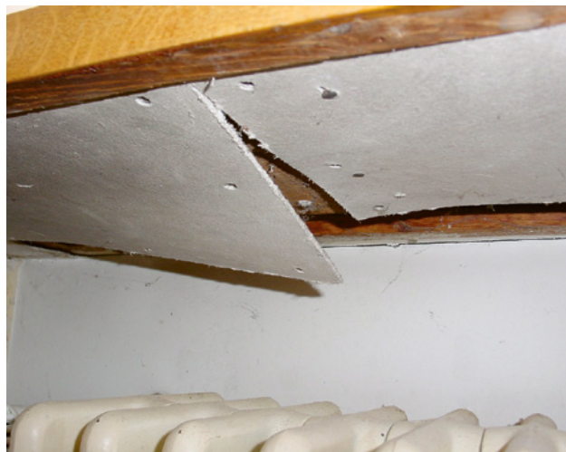
3 Pannelli leggeri contenenti amianto come rivestimento antincendio, ad es. sui termosifoni
