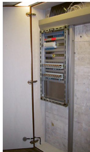
1 Pannelli leggeri contenenti amianto usati come rivestimento antincendio nei quadri elettrici; qui come rivestimento interno sulla porta
