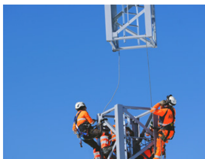
2 Sécuriser les zones à risque de chute.
