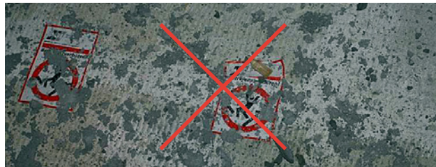
5 Gli adesivi di avvertimento sulle sigillature antincendio non sono sufficienti. Le sigillature devono essere resistenti allo sfondamento.
