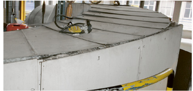
Asbesthaltige Dämmung hinter einer Verkleidung
