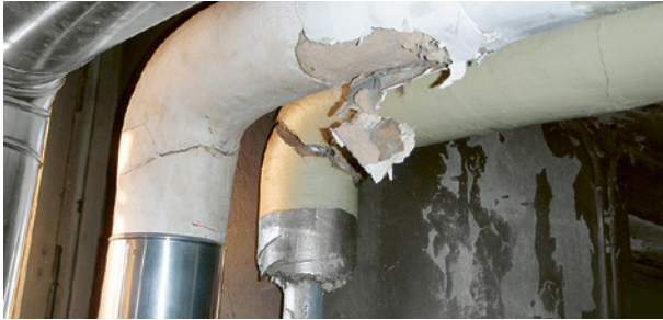
Rohrleitung mit asbesthaltigem Mörtel
