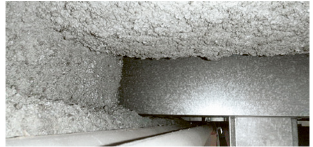
Spritzasbest als Brandschutz an Metallträger
