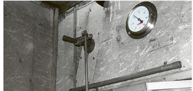
Lüftungskanal aus Asbestzementplatten
