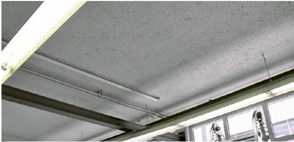
Spritzasbestbelag an Decke
