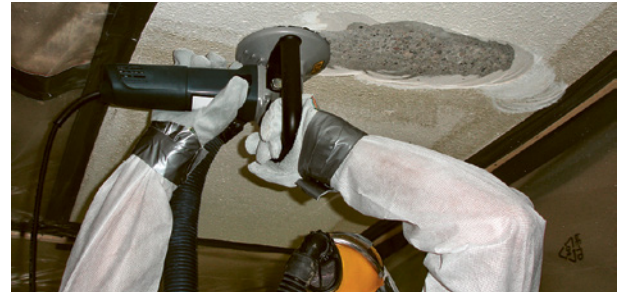
Entfernen nur durch ein anerkanntes Asbestsanierungsunternehmen
