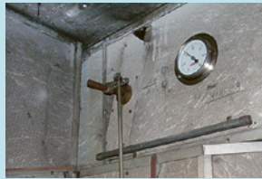
Lüftungsanlage aus Asbestzement
