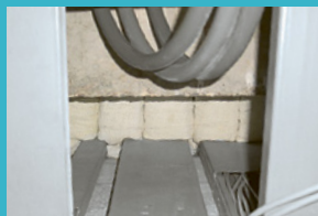
Brandabschottung mit Asbestkissen
