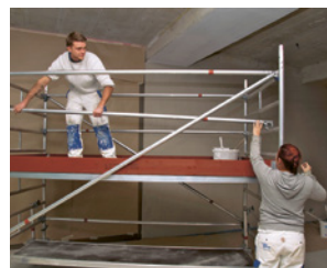
3 Protection latérale sur l'échafaudage roulant
