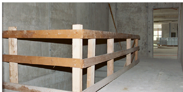
2 Zone à risque de chute à proximité d'une cage d'escaliers équipée d'un garde-corps.
