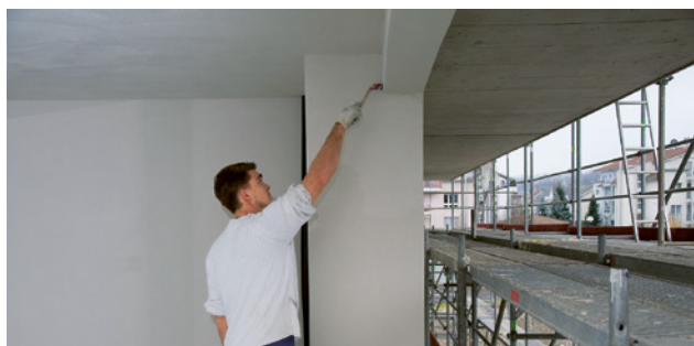
1 Zone dangereuse à proximité d'une façade: l'échafaudage sert de protection contre les chutes.
