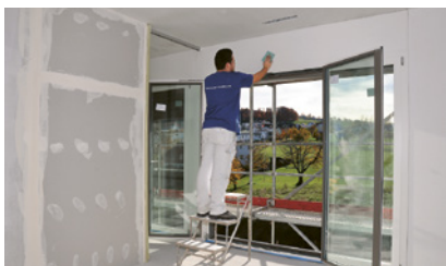
1 L'échafaudage de façade protège contre le risque de chute par la fenêtre ouverte.
