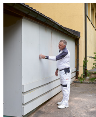
Règle 8 Se protéger contre les poussières d'amiante.
