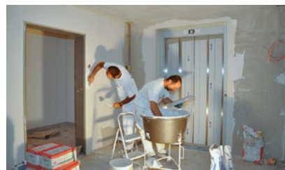
3 Une fois montée, la porte de l'ascenseur offre une protection contre le risque de chute.
