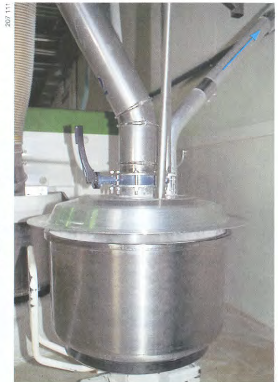
Bild 34 Optimale Absaugung bei einer Mehleinfüllung
