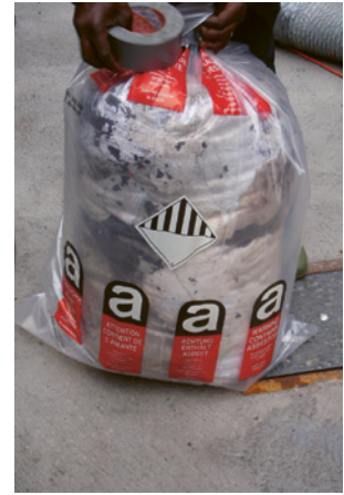
6 Kunststoff sack mit der Kennzeichnung Asbest
