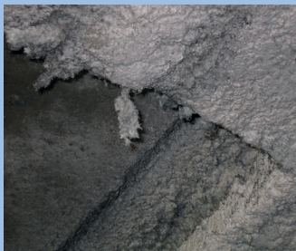
Rivestimenti in amianto spruzzato
