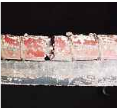
Fig. 6: installation de soudage défectueuse découverte lors d'une inspection.
