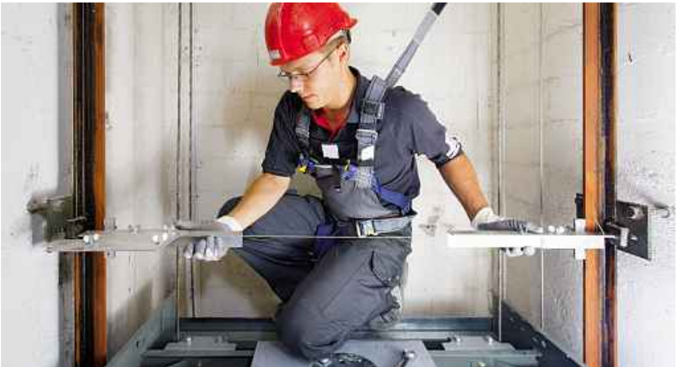
Comportement incorrect, mauvaise organisation et instruction insuffisante provoquent souvent des accidents.
