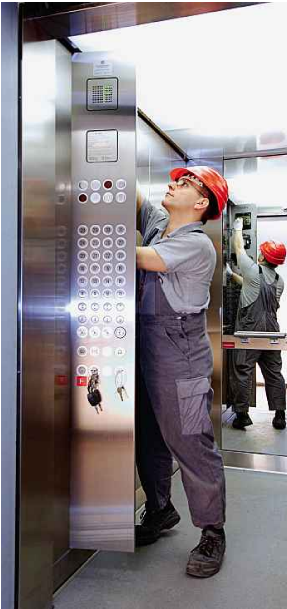
La compétence technique du personnel est déterminante pour la sécurité lors des travaux de maintenance.
