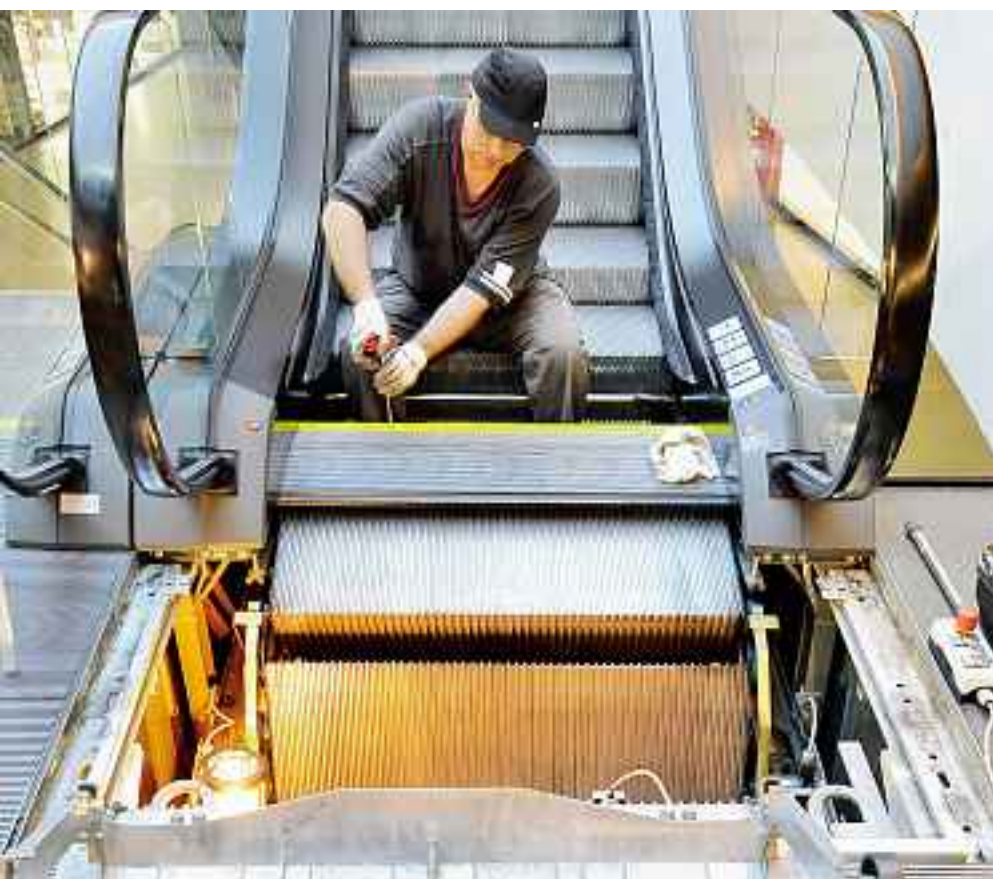
Sécuriser l'escalier mécanique contre tout risque de mise en marche intempestive, bloquer la zone et porter des gants et des chaussures de protection.
