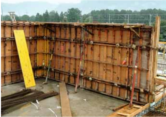
01 // Faux: les deux ouvriers qui travaillaient sur cette plateforme sont tombés sur le sol en béton. La protection latérale manquait aussi. // Photo: Suva
