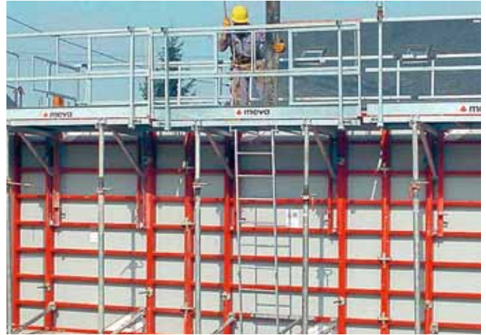
02 // Juste: protection latérale en trois parties sur une plateforme montée correctement. // Photo: zvg
